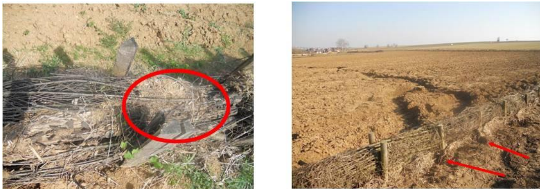
Figure 32: Exemples de dysfonctionnements, à gauche fascine débordée, à droite, fascine ravinée (photos G. Valentin, 2011)
