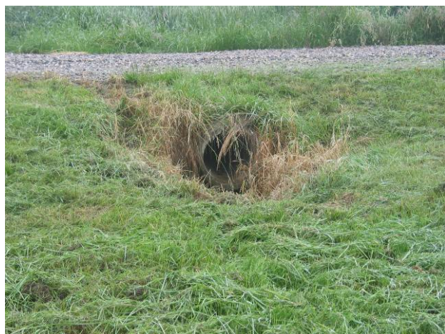
Photo 3: Mise en place d'une buse qui débouche sur une prairie non entretenue à l'amont des habitations (à Michelbach-le-Bas). La prairie ne retient plus le ruissellement la végétation étant trop haute et les eaux de ruissellement arrivent directement dans les habitations (Cliché : Heitz, 2004).
