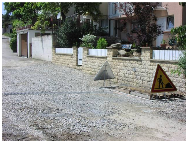
Photo 4 : Mise en place d'un réseau de canalisation entre les parcelles et les habitats (Blotzheim). En ces de pluies abondantes, les eaux y sont collectées et dirigées vers le réseau d'assainissement (Cliché : Heitz, 2004).
