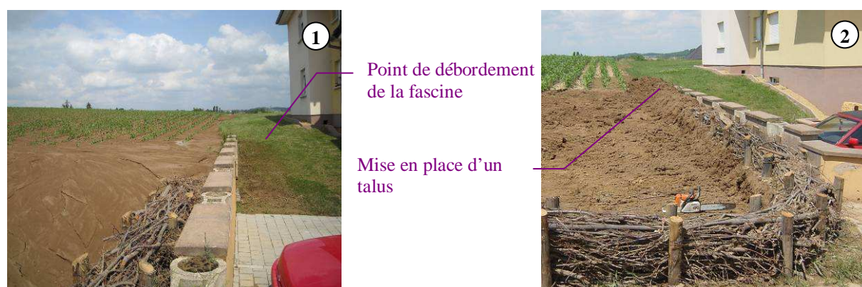
Figure 19 : Correction de la fascine (2) par rapport au dysfonctionnement constaté (1) (CG67)
